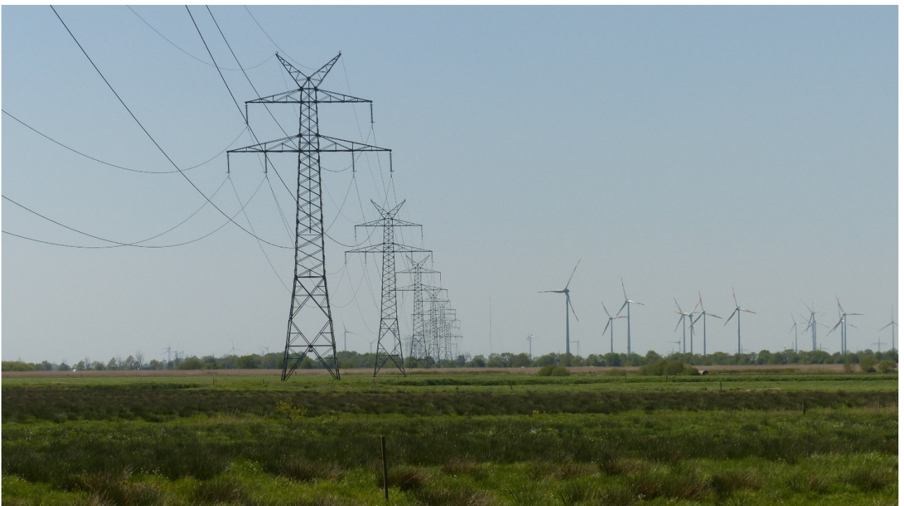
Abb. 31: Freileitung, die das PG im TG 1b, 1d und 4b zerschneidet
