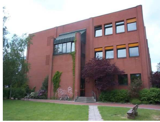
Gebäude 6, Jahrgang 11 bis 13. Hier sind verschiedene Dehnungsrisse in der Verblendfassade zu sanieren.
