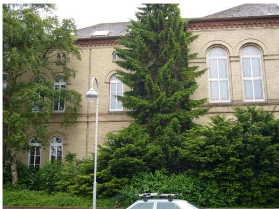
Altbau – Naturwissenschaftliche Räume und AUR- Gebäude A. Ein Teil der Rundbogenfenster muss erneuert werden, ebenso die im Dach erkennbaren Dachflächenfenster.
