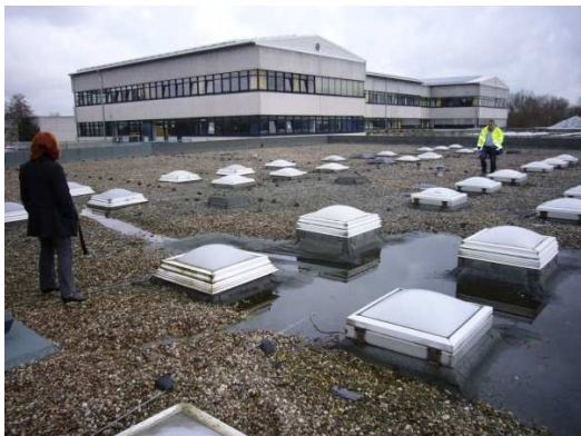
Gebäude 3, Jahrgänge 7 bis 10. Kernsanierung erforderlich. Die Flachdächer wurden bereits mit einem geneigten Blechdach incl. Wärmedämmung versehen. Die Flachdächer Musik/ Kunst, AWT sowie 4. Jahrgang wurden im Rahmen des Konjunkturprogramms 2009/2010 saniert.
